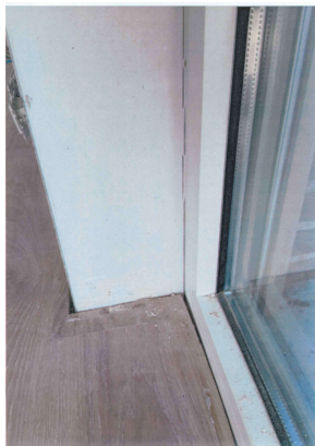
Afbeelding 17: (Onbestaande) uitzetvoegen zoals het niet voorgeschreven is.
